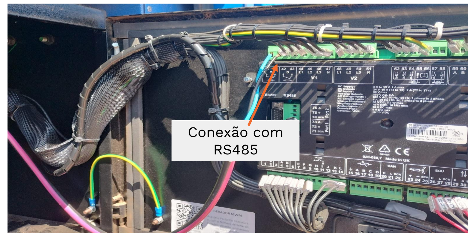
Connect 2.0 conectado ao um medidor de energia através da RS485 me protocolo Modbus RTU
